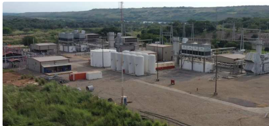
Planta de generación eléctrica Drummond Ltd.
