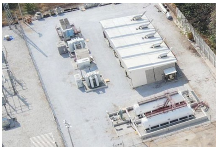
Fotografía 1-9 Generadores eléctricos y transformadores
